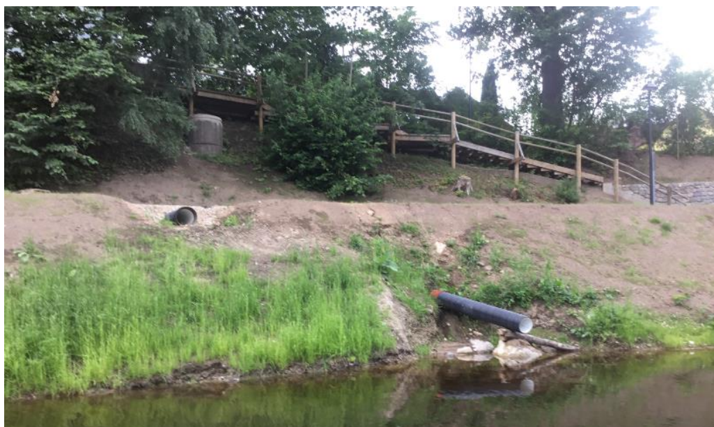
12. attēls Potenciālās ūdensaugu aizauguma vietas Vidus ūdenskrātuvē – vietās, kur no jauna ierīkotas notekcauruļu ieplūdes vietas
